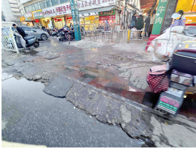
东门附近污水跑冒道路破损
