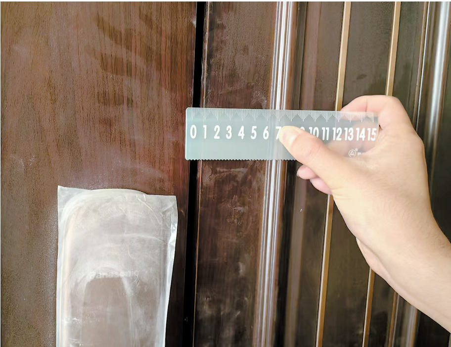
记者现场实测门缝为6至7毫米
