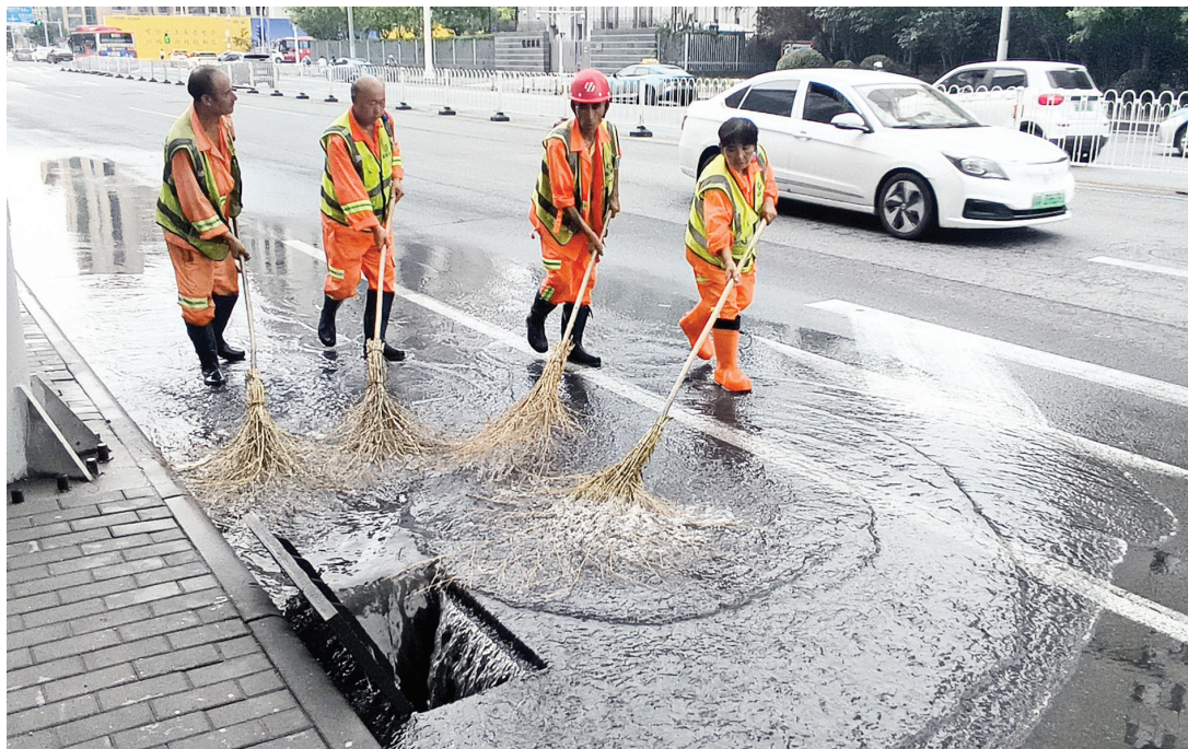
近日,本市持续降雨,部分坑洼路段出现少量积水,环卫工作人员及时对路面积水进行清理,确保市民出行。图为环卫工人在城厢东路清理积水。
