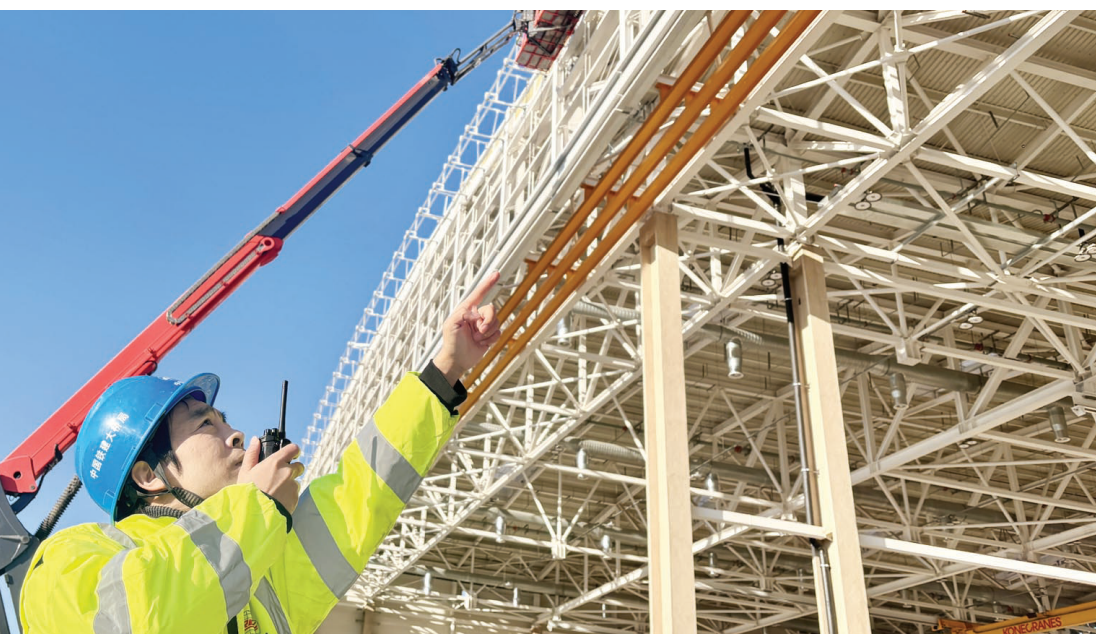
元旦假期,中国铁建大桥局施工人员坚守在空客天津A320系列飞机第二条总装线项目进行厂房建设。 记者 张磊 摄
