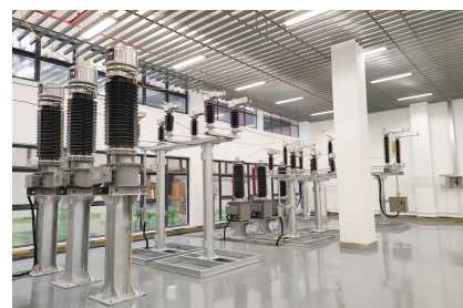
广州铁路职业技术学院实训室高压一次性区域实拍图。
