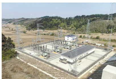
哈大高铁综合自动化系统——所亭整体图。
