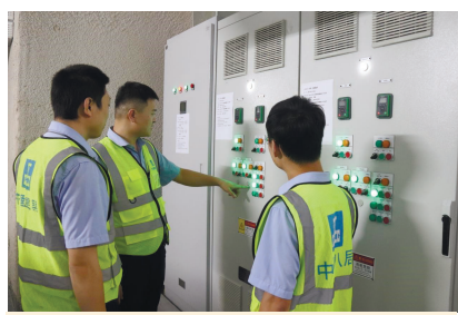
控制机电机组为上合组织天津峰会场馆提供服务
