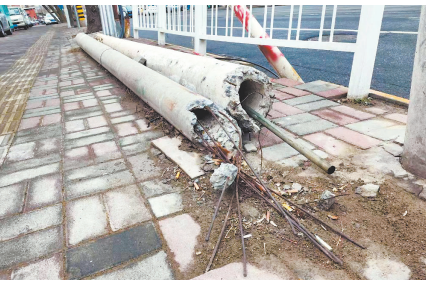
废弃线杆清理前,钢筋裸露
