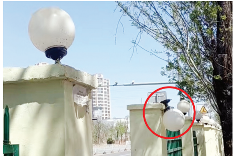
龙居公园围墙顶上球形灯损坏
