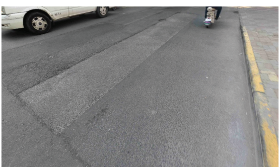
道路坑洼随处可见
