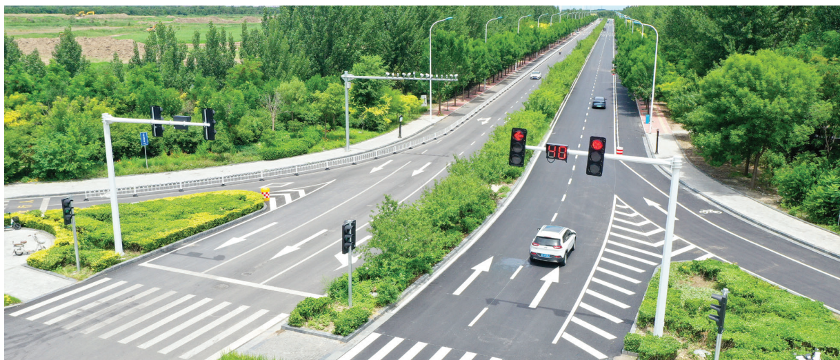
日前,东丽区芳樱路大修完工恢复通车。芳樱路是东丽湖区域内一条重要道路,连接美娟道、雅兰道和东丽大道。本次大修工程包括对道路整体进行全面翻修、完善交通设施及人行道整体修复等施工内容。 记者 周伟 摄
