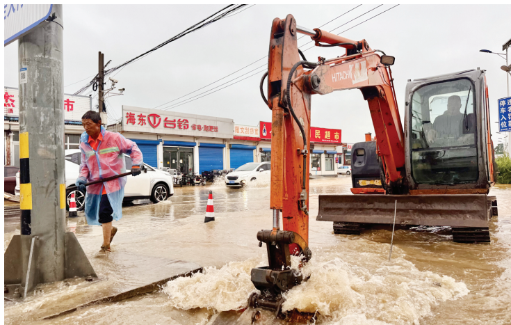
喜邦公路积水淤堵，机械人力同步抢险排涝。
