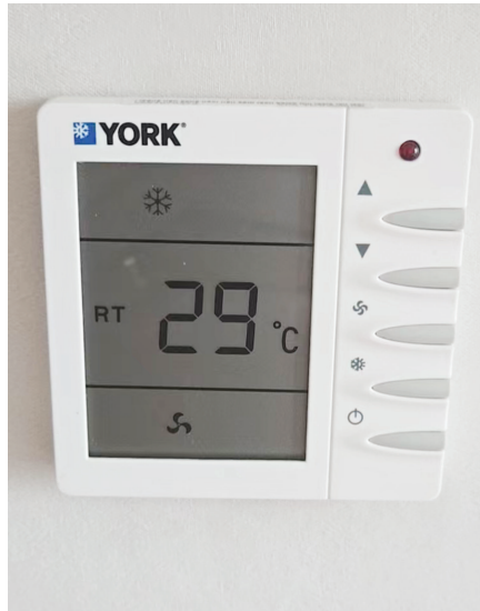
空调控制面板显示室内温度
