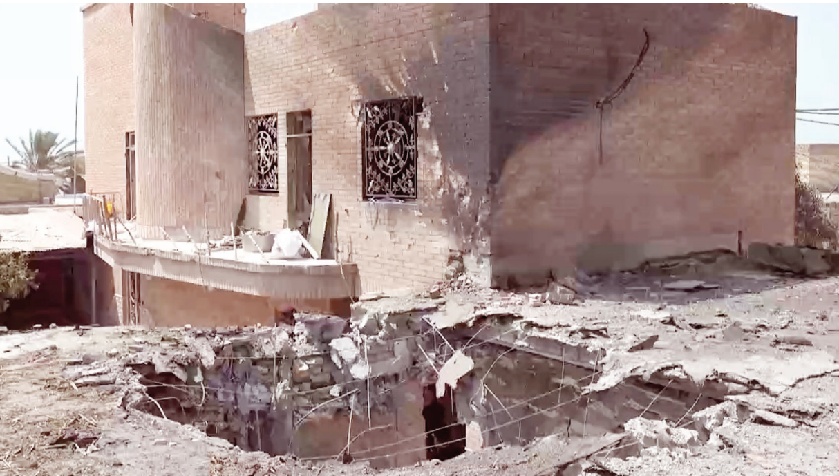
美军空袭事发地附近一片破败,许多房屋外观严重损毁,屋顶和墙壁被炸穿,留下很大的洞。 图片据央视新闻
