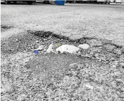
破损坑洞修整前
