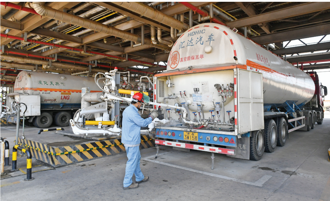
截至9月16日,国家管网集团天津LNG接收站自投产以来累计液态外输量突破2000万吨,也成为全国首个槽车外输量突破100万辆的LNG接收站。
