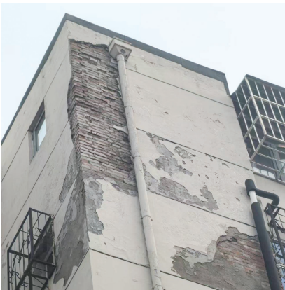
外墙大面积脱落
